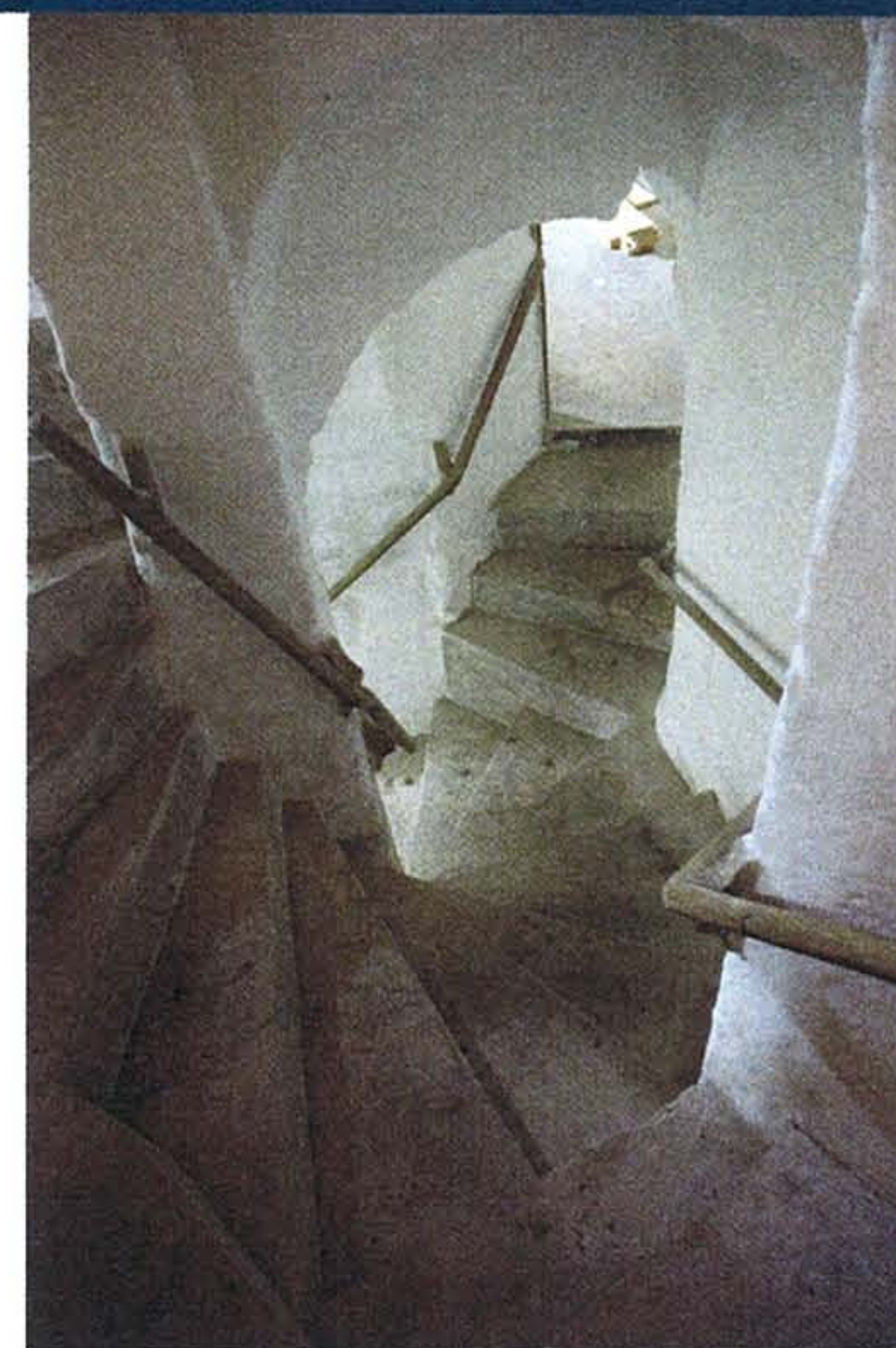
Achtzijdige traptoren. Na restauratie (NR). De wanden zijn met natte kalk bewerkt, de treden aangesmeerd met metselspecie. Foto Hans Bollebakker
